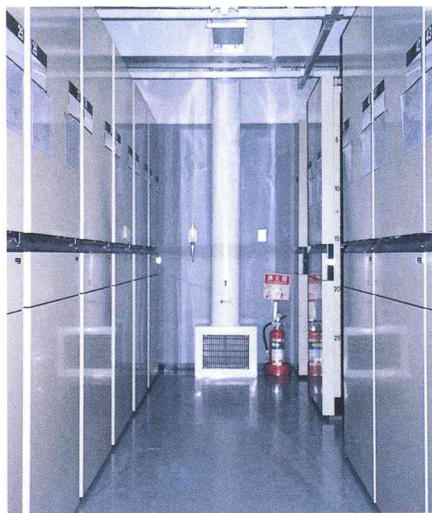
床面に設置した還気口
